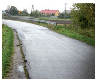
Droga w Michałowie przed remontem...
