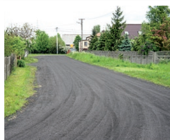
Droga w Janiszewicach przed remontem...
