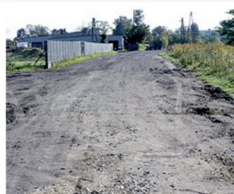
Droga w Opiesinie przed remontem...
